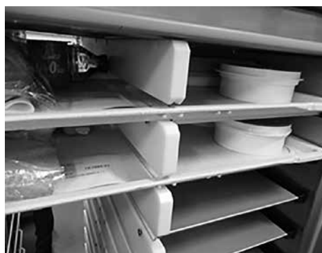
（右側パネルヒーター）
