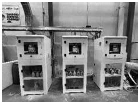
写真③:洗剤自動投入機
