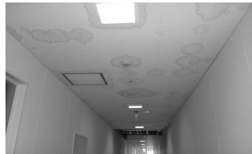
スプリンクラー漏水
